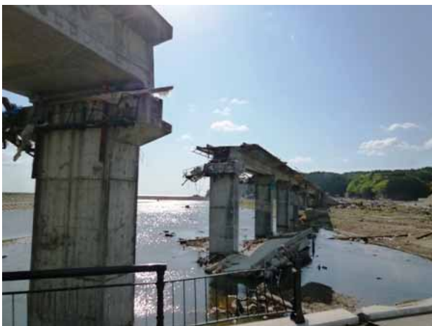
J R 気仙沼線の流出した橋げた (小泉大橋南側)【気仙沼市】 (撮影：今瀬政司、2011年5月15日)
